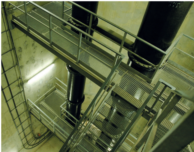
Teil des Kanalnetzes: ein Regenrückhaltebecken.
