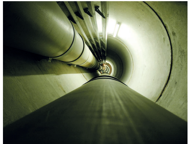
Blick in das Kanalnetz Bremerhavens, das von der BEG betrieben wird.
